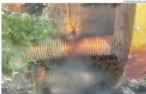
Fuga en el emisario detectada en diciembre de 2025 por la Cofradía.
