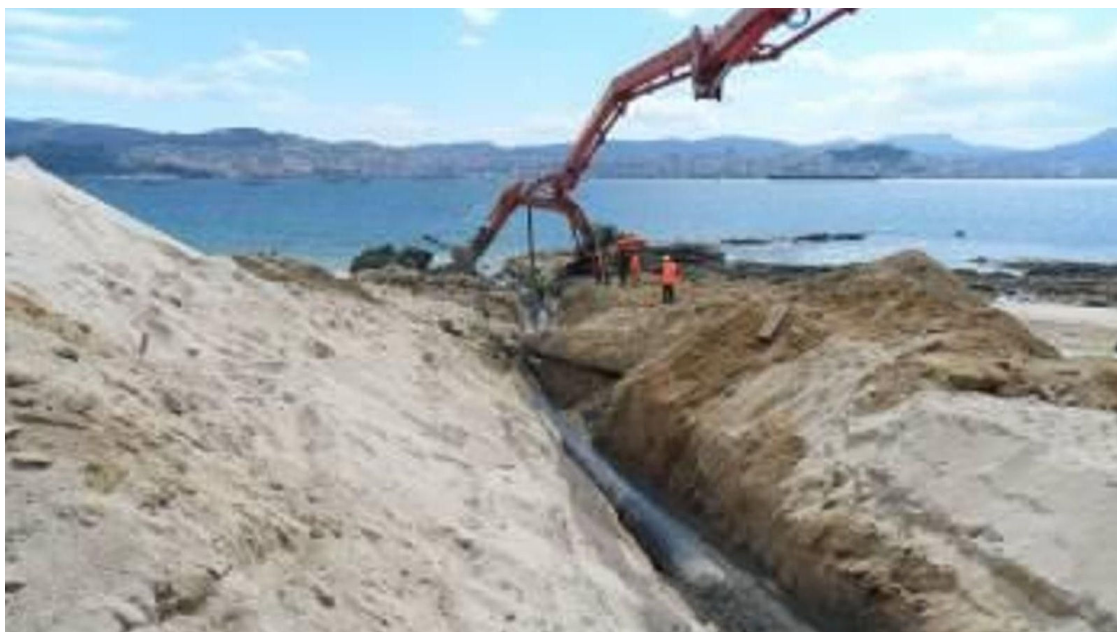
Detectan una fuga en el emisario que conduce el agua al Morrazo
